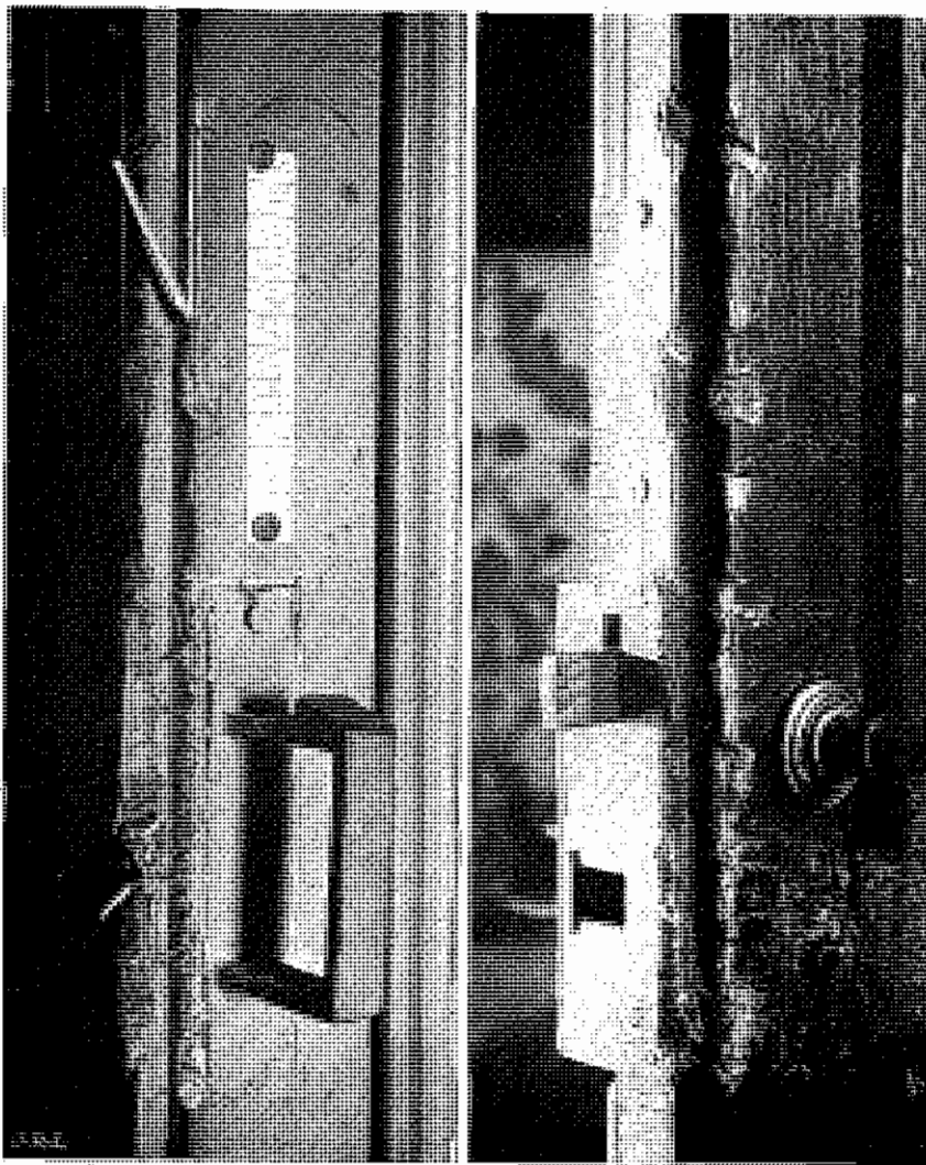
FIG. 28. — Le montant et le battant d'une porte fracturé par un cambrioleur novice, (attaque de la porte près de la serrure).
